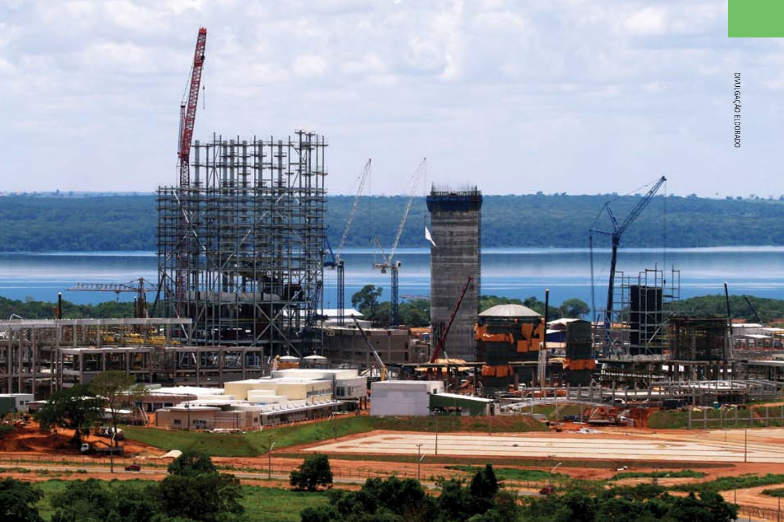
Cronograma de obras da Eldorado Brasil segue conforme o planejado e já apresenta avanço de 58%
