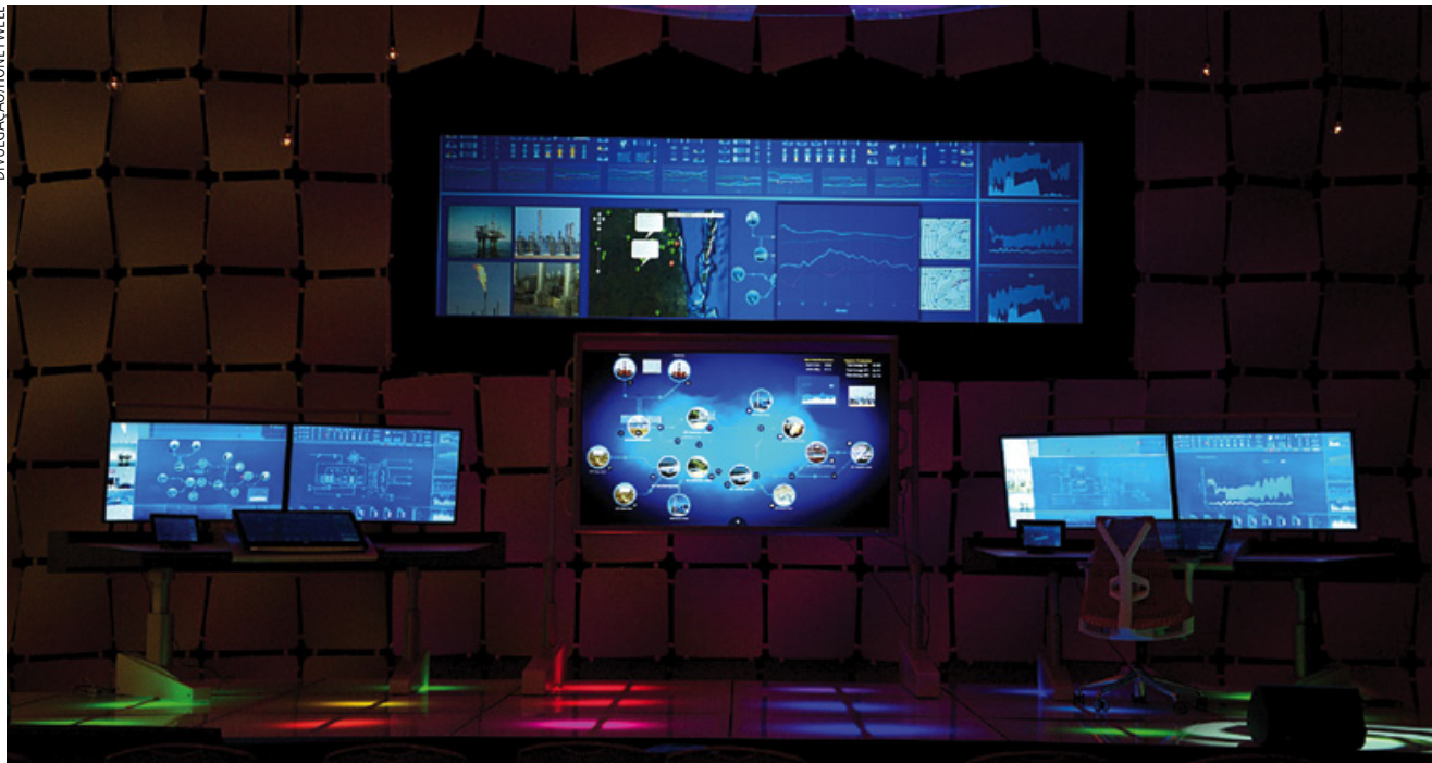
A Honeywell introduziu uma série de novas tecnologias que irão moldar a sala de controle da planta industrial no futuro, incluindo um console de operações futurista, com a Experion Collaboration Station (equipamento central na foto)
