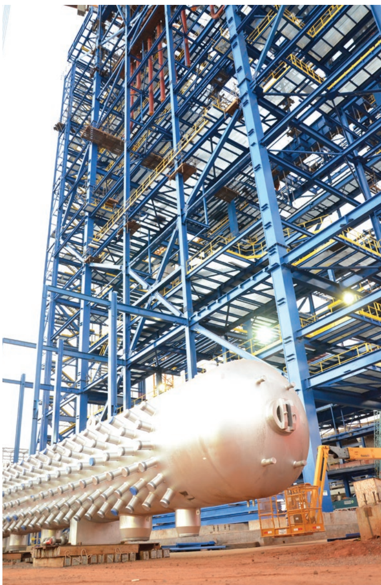
Com aproximadamente 200 toneladas, o balão da caldeira é responsável por concentrar todo o vapor gerado na caldeira de recuperação e encaminhá-lo ao processo de geração de energia elétrica da unidade
