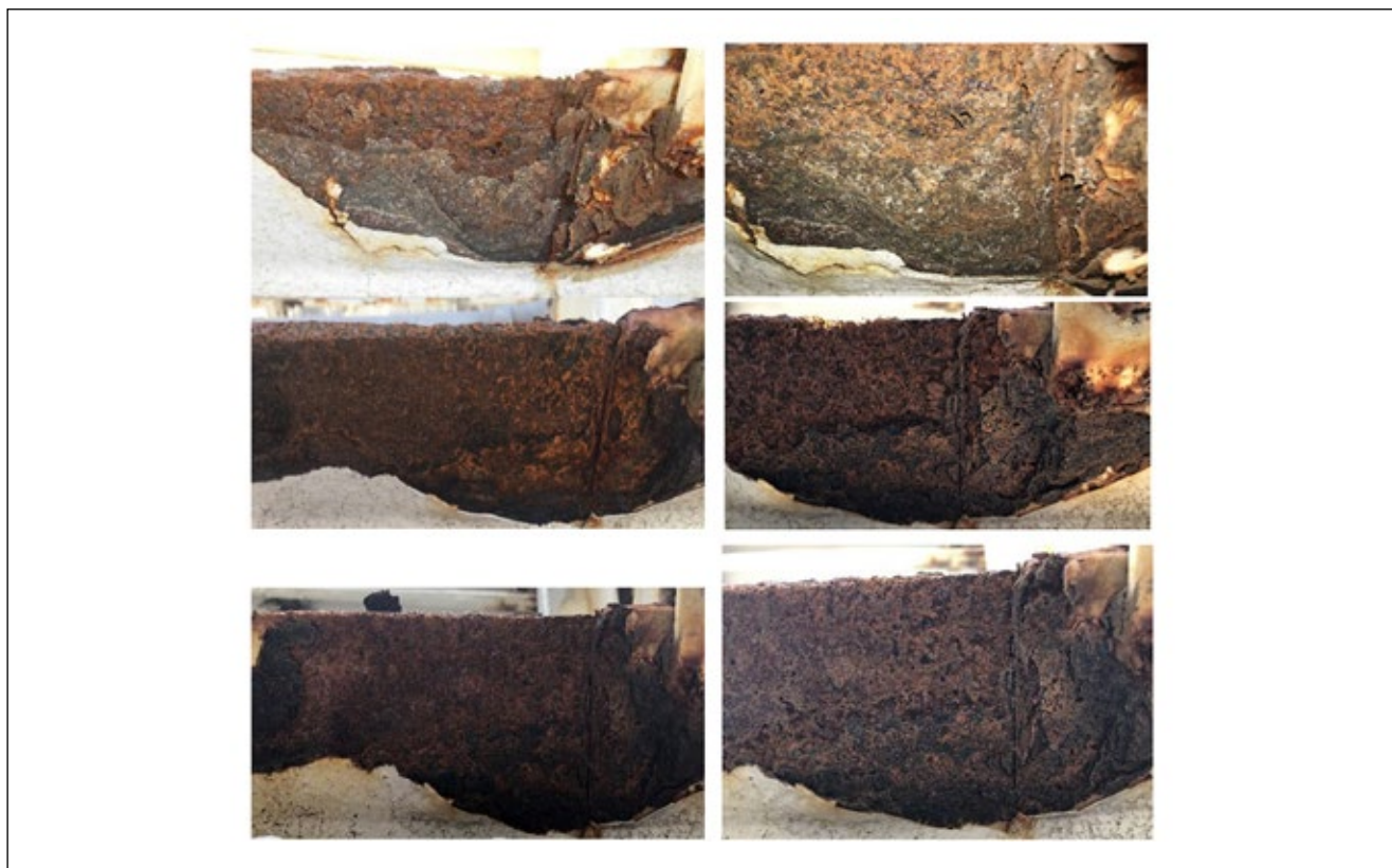
Figura 3. Foto do local protegido pelo anodo eletrônico no início da instalação, após seis semanas, doze semanas e ao final de um ano
