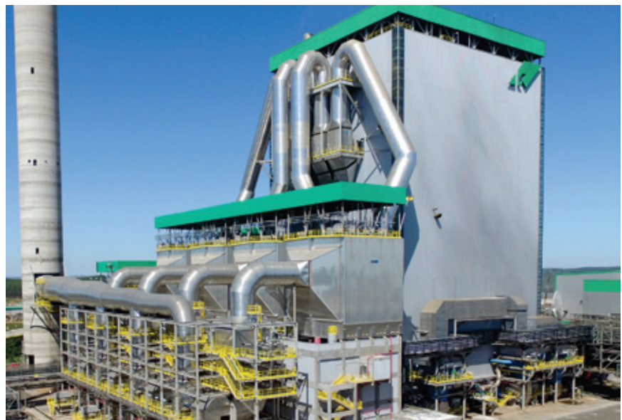
Caldeira de Recuperação Química de 7000tss/d (1.200t/h), de 104 bar(g) de pressão e 503 °C de temperatura, fornecida juntamente com uma Caldeira de Biomassa tipo BFB, em operação desde 2016 na unidade da Klabin em Ortigueira-PR. Trata-se de uma das maiores caldeiras de recuperação de alta pressão e alta temperatura em operação no Brasil.
