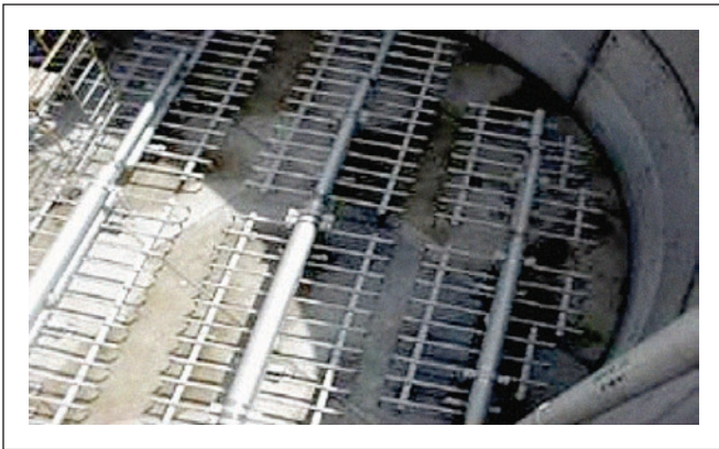
Figura 3. Sistema de aeração do reator MBBR
