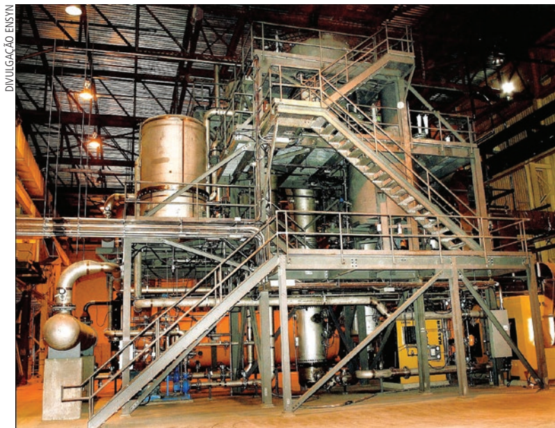
Planta da Ensyn em Renfrew, em Ontario (Canadá), com produção de 3 milhões de galões/ano
