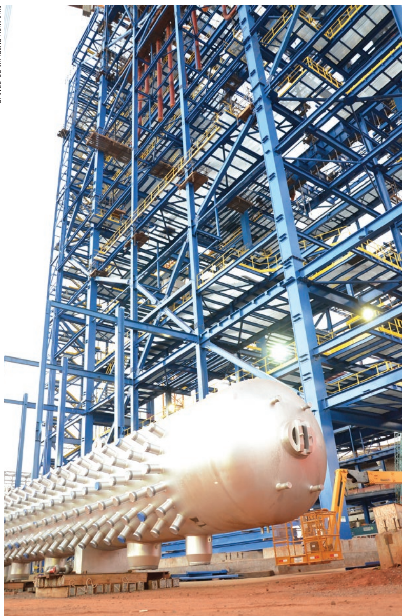
Com aproximadamente 200 toneladas, o balão da caldeira é responsável por concentrar todo o vapor gerado na caldeira de recuperação e encaminhá-lo ao processo de geração de energia elétrica da unidade
