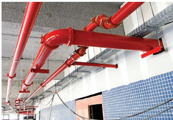
Figura 3. Uso da solução para linhas de combate a incêndio
