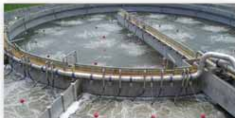
TRATAMENTO DE EFLUENTES
