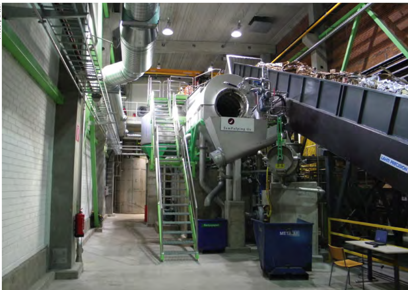
Figura 3. Tambor de lavagem de rejeitos
