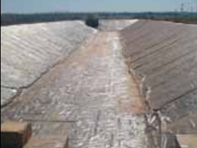
Lagoa de emergência e aeração Três Lagoas, MS
