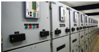
Sistema de distribuição de energia em MT
