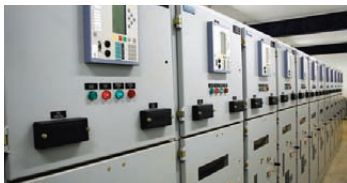
Sistema de distribuição de energia em MT
