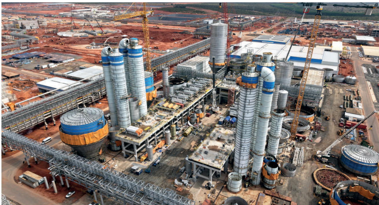
Vista aérea dos equipamentos já instalados no canteiro de obras
